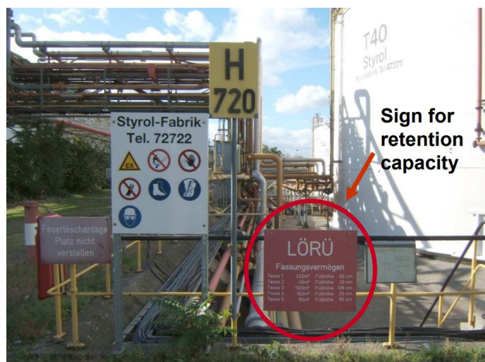
2. fénykép: oltóvíz felfogó tároló létesítmény [10]
